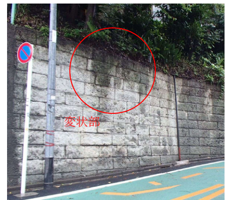
写真 1 変状した大谷石擁壁
