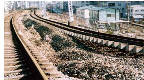
鉄道普通盛土の被災状況
