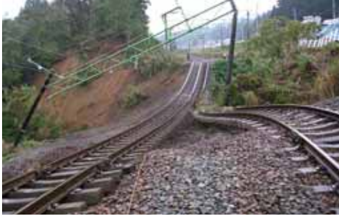
(a)崩壊状況 1
