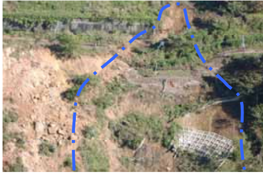
(b)崩壊状況 2
