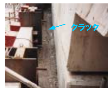
図8 試験終了後の背面盛土の状況（A3橋台）
