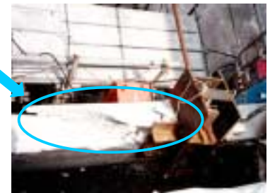
図4 試験終了後の壁面工の圧壊状況（A3橋台）
