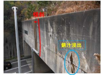
写真1 パラペットの状況
